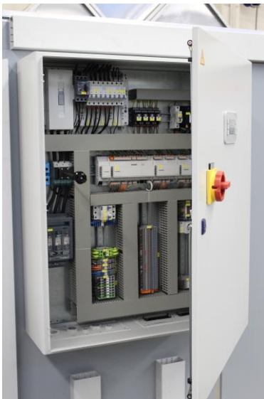
Abbildung 2: Schaltschrank am RLT-Gerät angebaut
