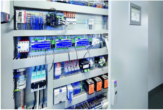
Abbildung 1: Schaltschrank in wandhängender Ausführung
