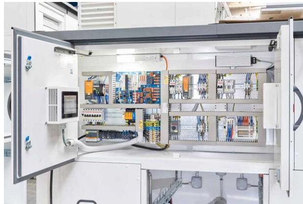
Abbildung 3: Schaltschrank im RLT-Gerät integriert
